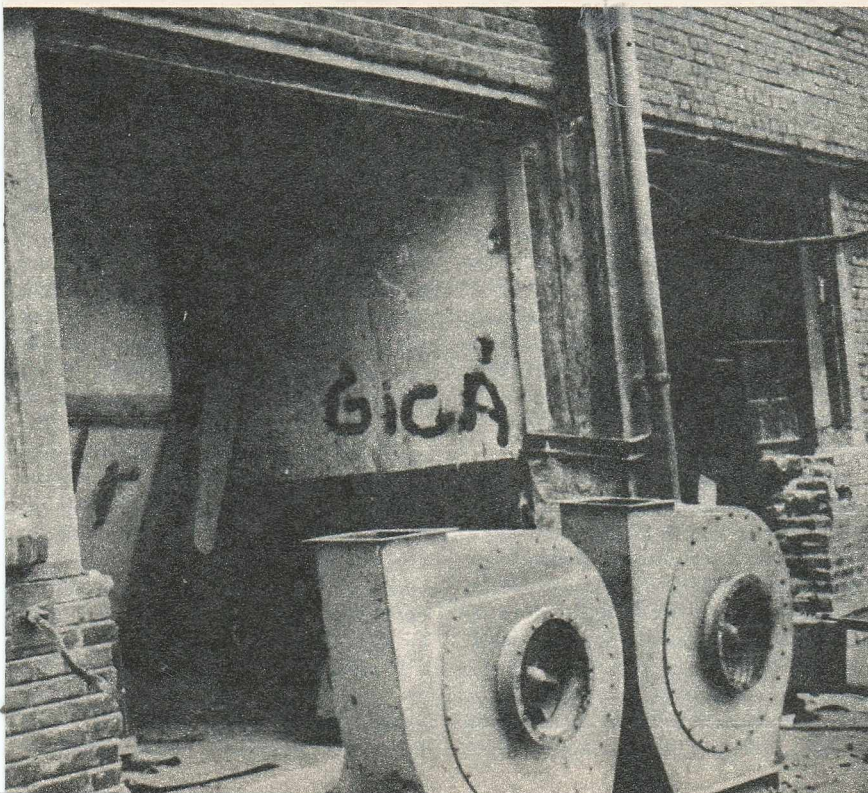
Instalațiile de introducere a aerului cald zac nemontate. Constructorul așteaptă oare să se mai încălzească atmosfera? Să nu se frigă!
