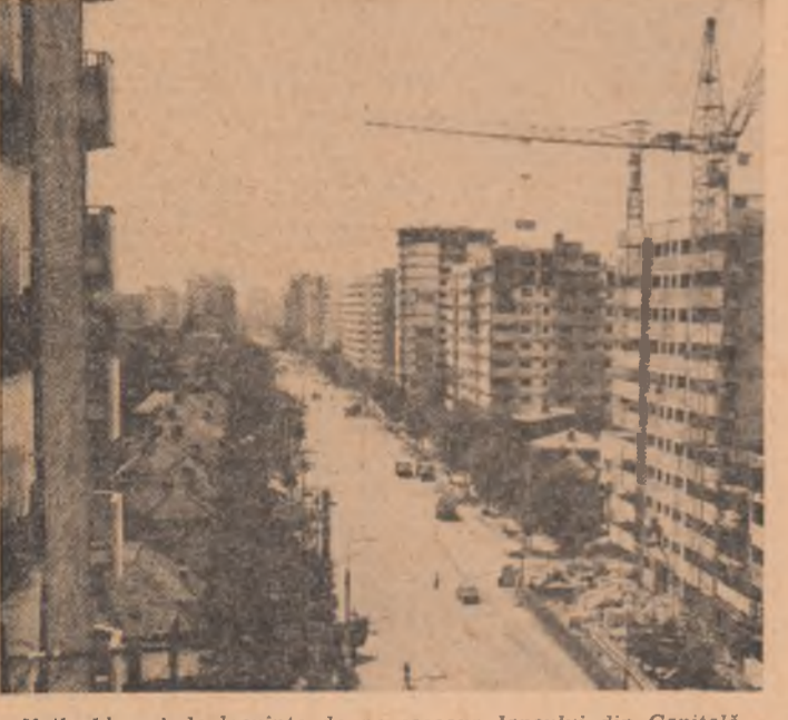
Noile blocuri de locuințe de pe șoseaua Iancului din Capitală. Foto: GH. CUCU
