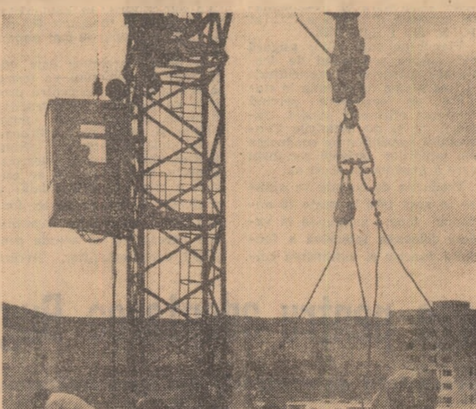
În cartierul Măndăș, din municipiul Cluj-Napoca, constructorii înalță un nou bloc de locuințe.
