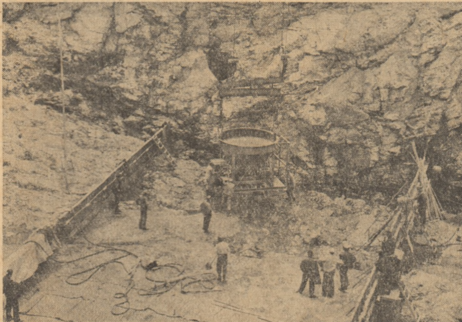
Este data de 28 mai, ora 20. Premieră absolută. Prima benă „popeșe” în corpul barajului. O sărbătoare trăită la temperatura înaltă a munților
