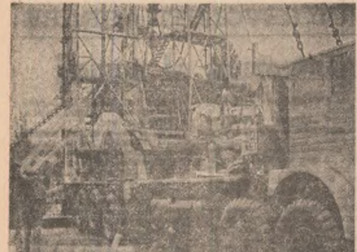
Punerea în producție a sondelor cit și forajul propriu-zis poate beneficia de această realizare de vîrf a industriei românești și instalația auto-transportabilă, montată pe șasiu special de mare capacitate
