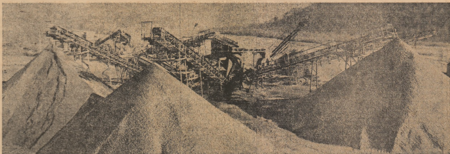
Vedere generală a stației de sortare a balastului în vederea preparării betoanelor. Organizată în preajma comunei Paltin, această stație automată de sortare va asigura necesarul pentru toate cele cinci microhidrocentrale ce vor fi construite pe riul Zăbala
